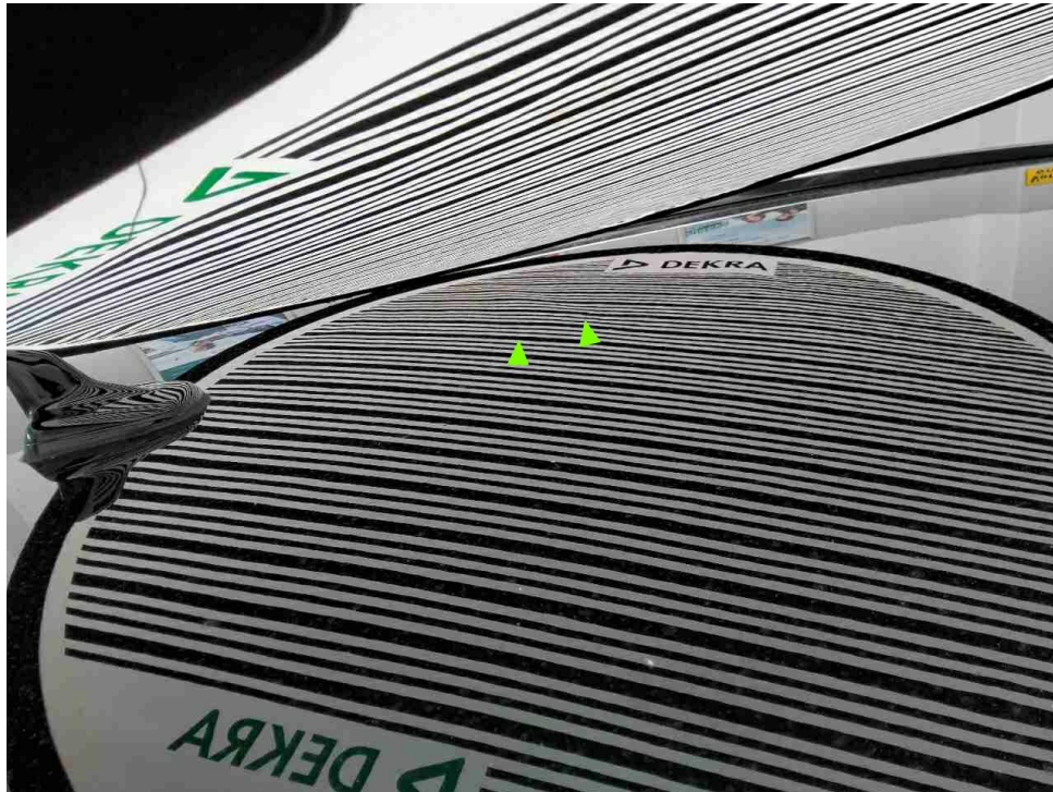
Bild 29 : Hagelähnliche Dellen im Dachbereich
