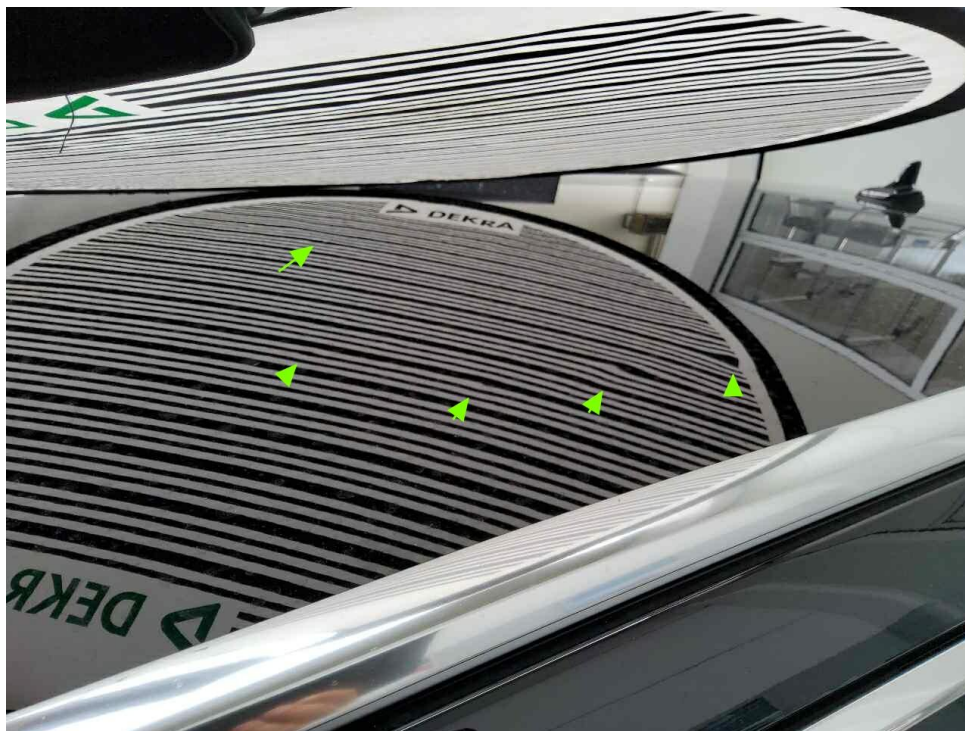
Bild 28 : Hagelähnliche Dellen im Dachbereich
