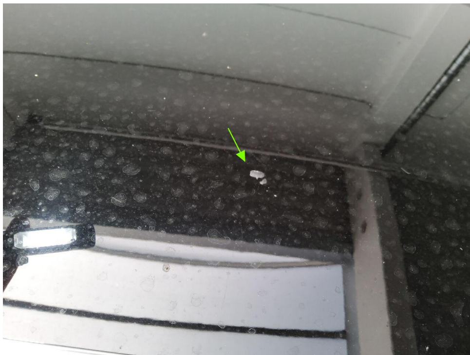
Bild 27 : Dach Kratzer und Umweltflecken, polieren
