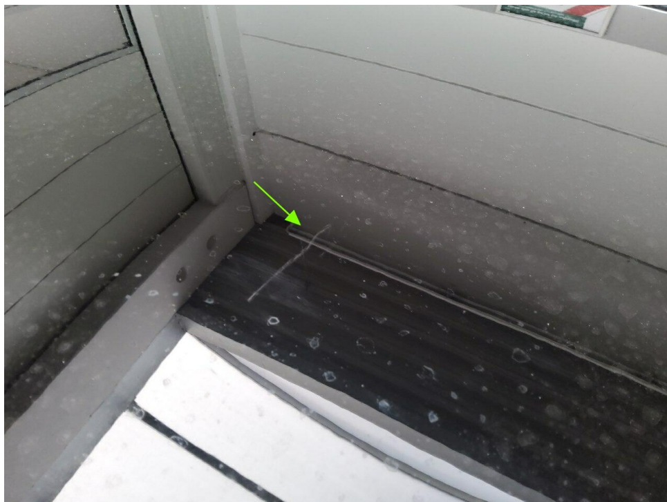
Bild 26 : Dach Kratzer und Umweltflecken, polieren
