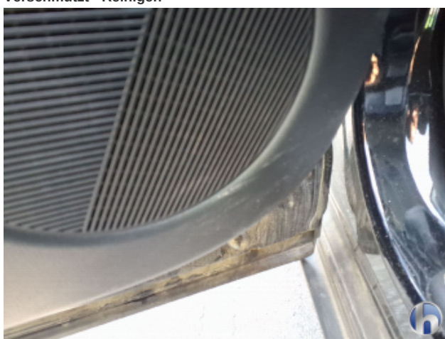
11. Verkleidung Verschmutzt - Reinigen
