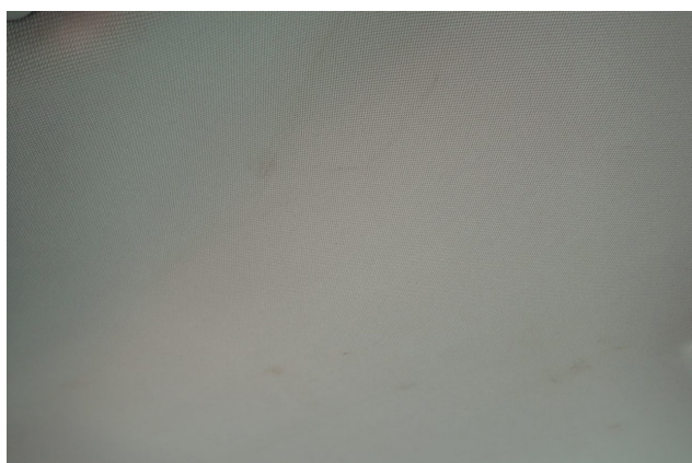
Beschädigung 2: Interieur: Innenraum - verschmutzt - reinigen
