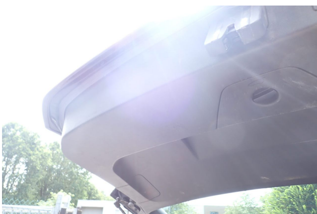
Beschädigung 10: Verkleidungen/Abdeckungen: Heckdeckel, Innenverkleidung - Kratzer - Smart Repair
