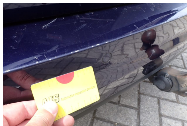
Beschädigung 13: Stossfänger hinten: Stossfänger hinten - verkratzt / verschürft - instandsetzen und lackieren
