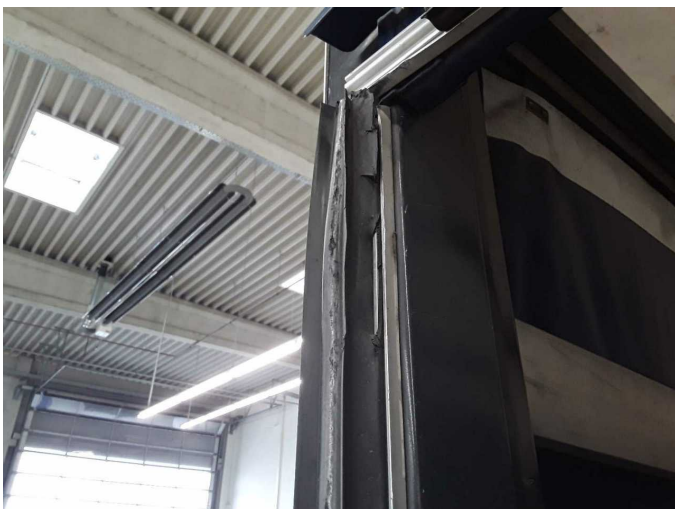
Damage 9: Misc.: Misc. (Portaldichtung links) - Broken / torn - Replace
