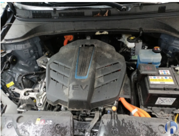
3. Motor Marderbiss /-schaden - Erneuern
