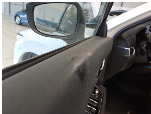
Beschädigung #12: Verkleidungen/Abdeckungen: Türverkleidung vorn links - verformt - erneuern
