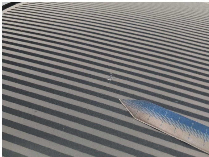
Damage 8: Roof: Roof (Mehrkosten möglich) - Paint defect - Conditioning
