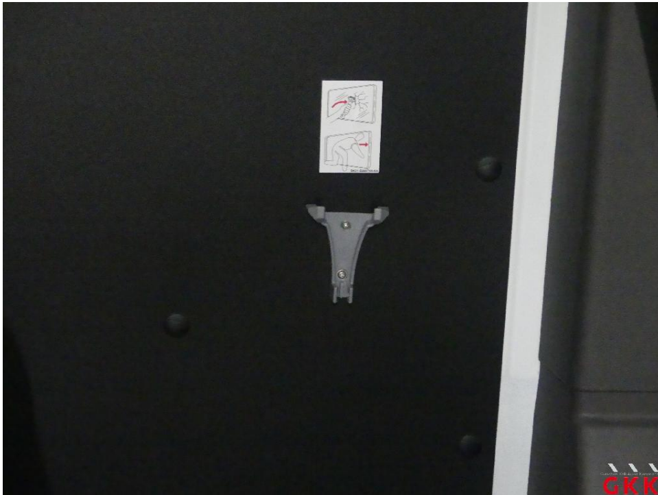
Bild 27 Nothammer, fehlt, ersetzen
