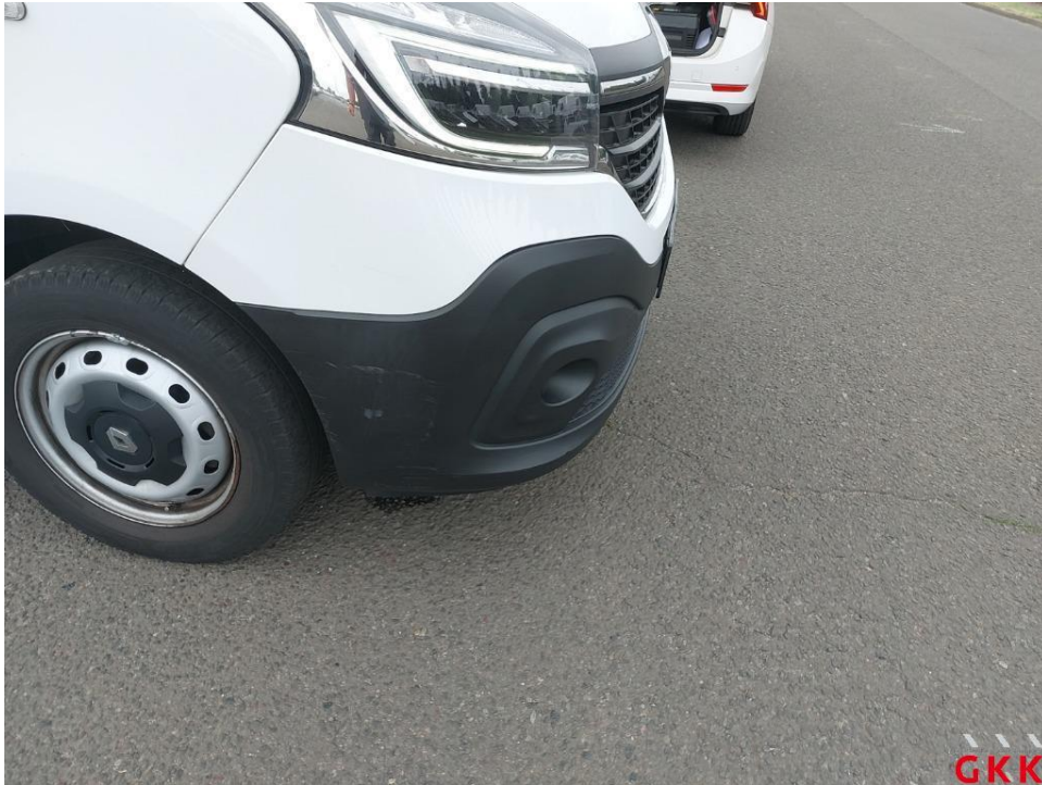
Bild 21. Stoßfänger vorne, Verkleidung -teillackiert-, beschädigt, ersetzen
