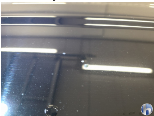
2. Dach Harz-/ Säureeinwirkung -
