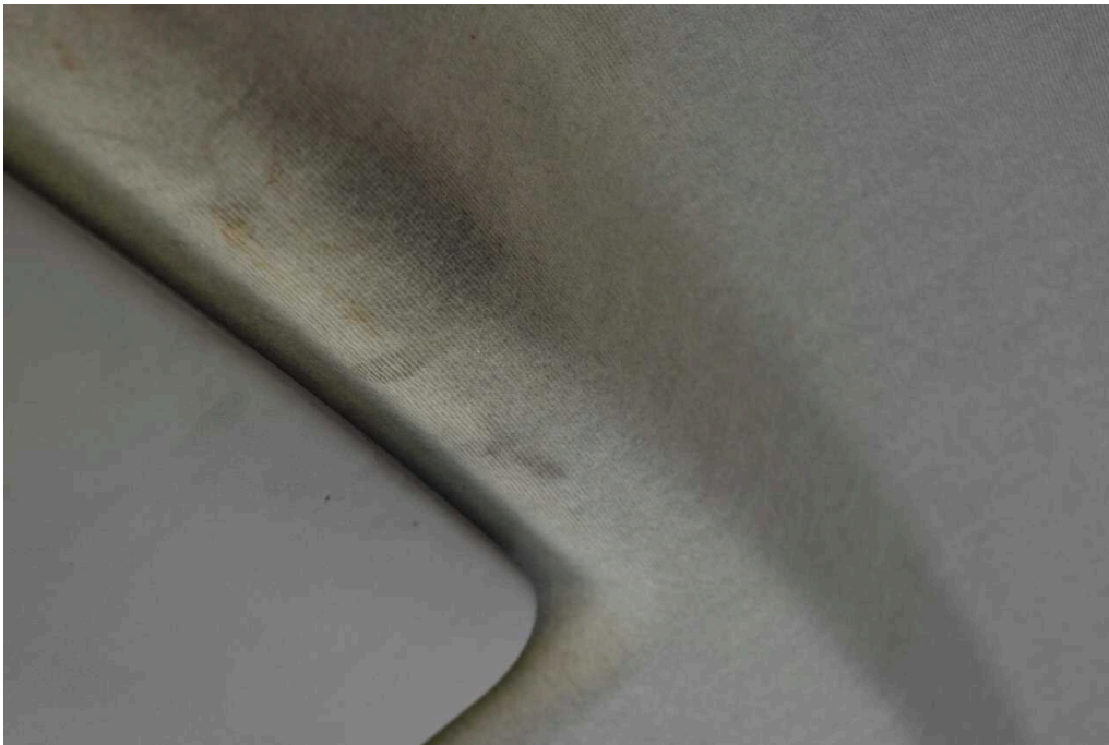
Bild 18 Innenraum Innenraum stark verschimmelt
