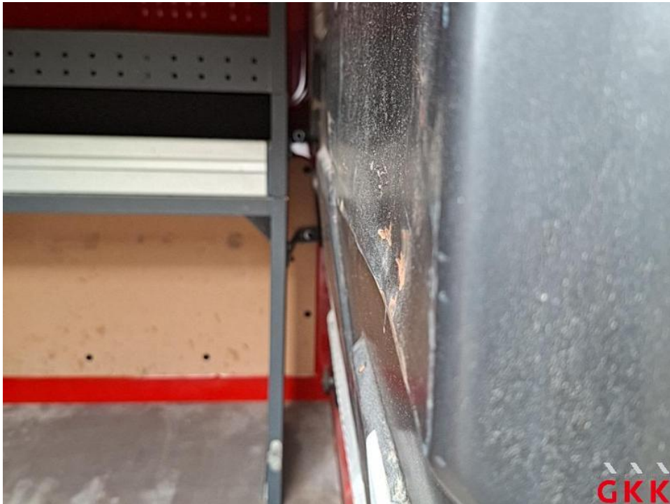
Bild 38. Trennwand, oberhalb, beschädigt, ersetzen
