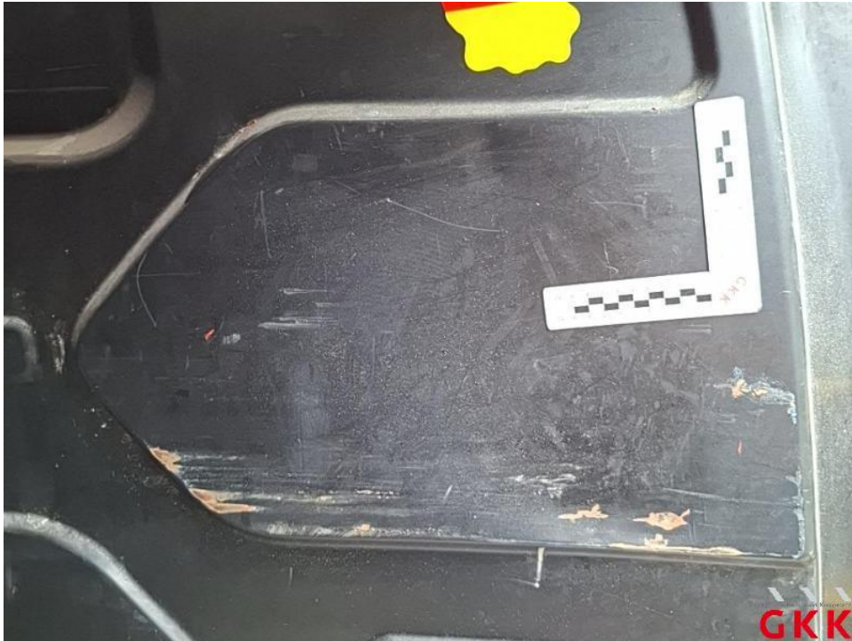
Bild 37. Trennwand, oberhalb, beschädigt, ersetzen
