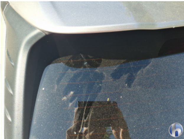
18. Fenster Außen hinten Kratzer - Erneuern
