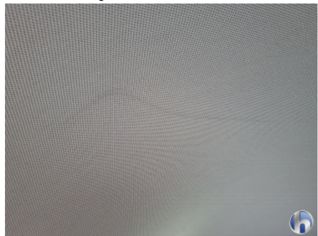
7. Dachhimmel Verschmutzt - Reinigen
