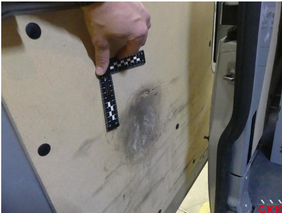
Bild 14 Schiebetür rechts, Innenverkleidung -Abdeckung-, beschädigt, ersetzen
