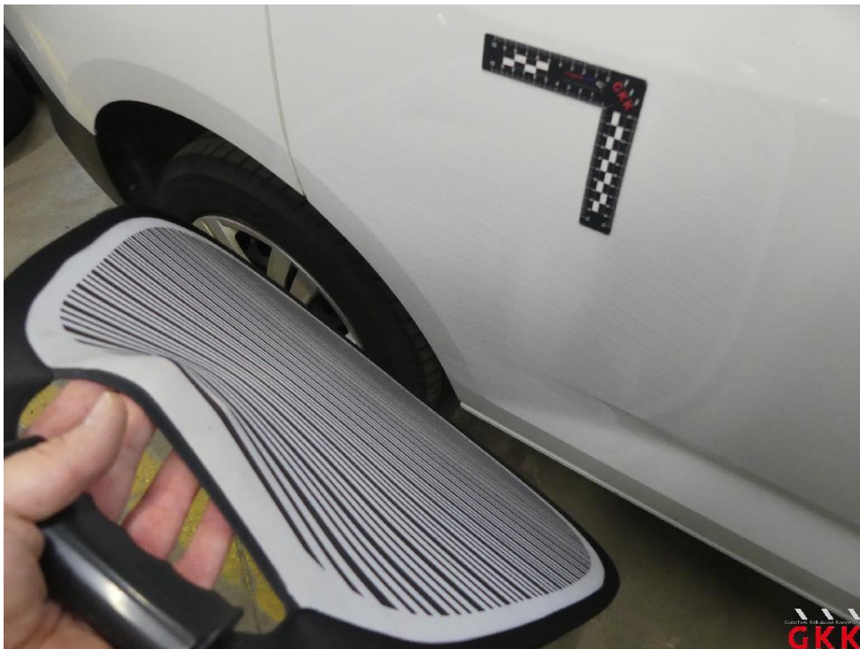
Bild 16 Tür hinten rechts, beschädigt, instand setzen - lackieren
