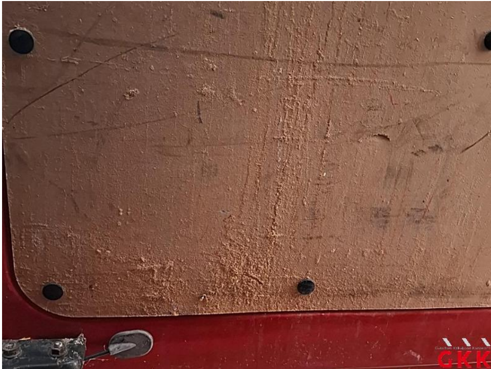
Bild 39. Schiebetür rechts, Innenverkleidung, beschädigt, ersetzen
