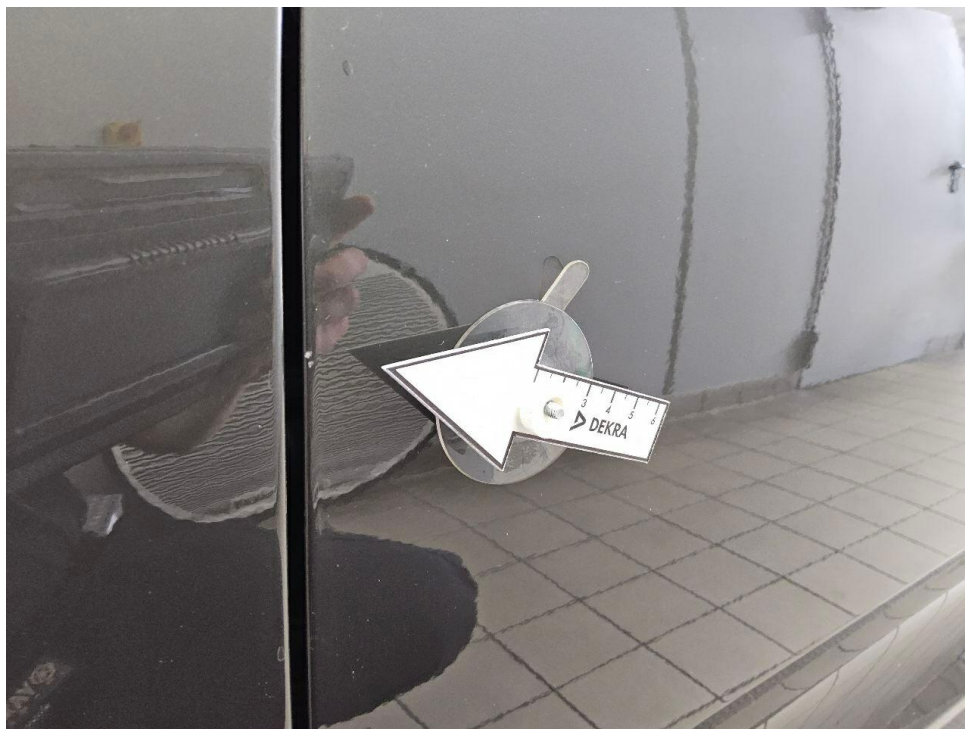
Bild 31 : Tür vorne links Kante kleine Kratzer, ausbessern
