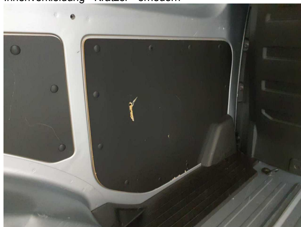
Beschädigung #10: Verkleidungen/Abdeckungen: Laderaumverkleidung links - gebrochen / gerissen - erneuern
