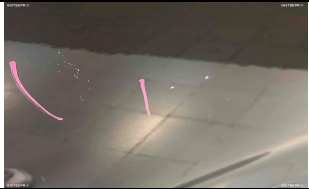
Foto daños externos 1
