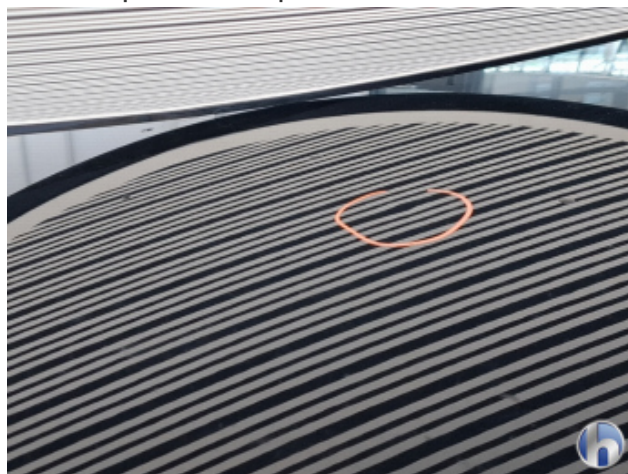
5. Dach Gebrauchsspuren - Ohne Reparatur
