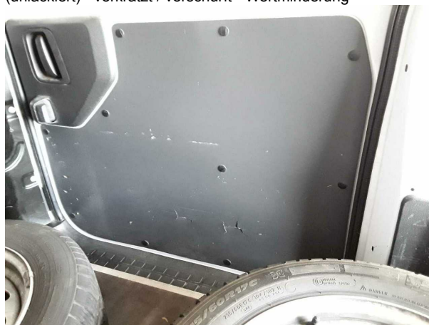
Beschädigung #9: Schiebetür rechts: Verkleidung - beschädigt - erneuern
