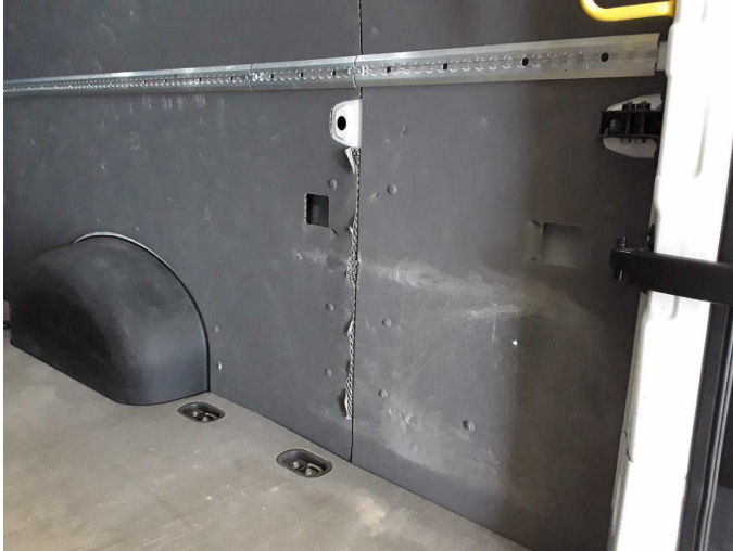
Damage 1: Interior: Interior (Laderaumverkleidungen) - Broken / torn - Replace
