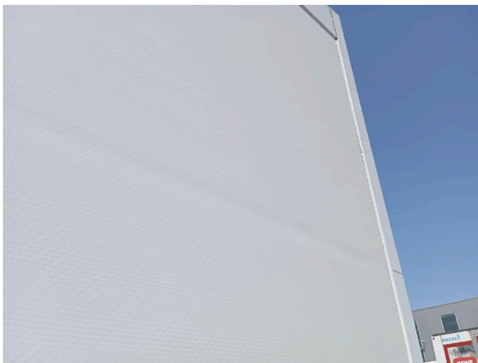
Bild: 32 Kühlkofferseitenwand links streifend verkratzt und leicht eingedrückt
