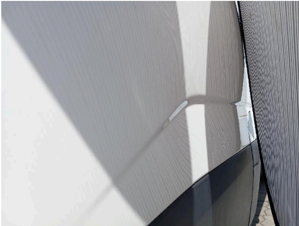
Bild: 29 Tür links deformiert
