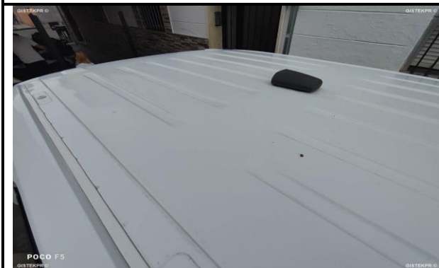
Foto daños externos 1
