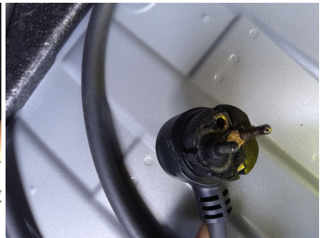
Cable de carga / - / Faltante
