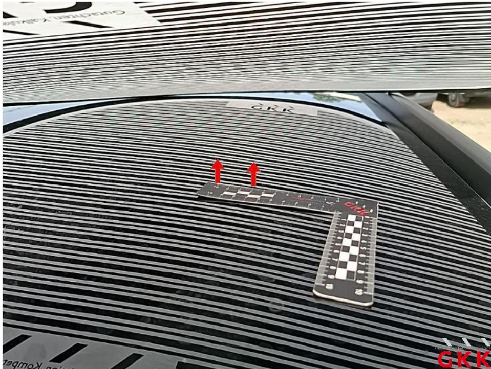
Bild 79. Dach, beschädigt, instand setzen - lackieren
