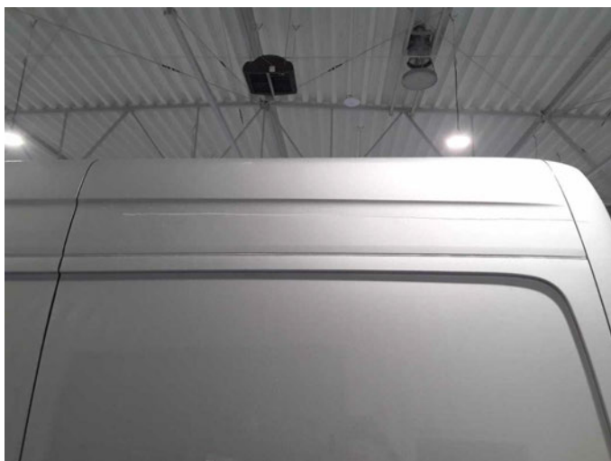
Beschädigung 20: Fahrzeugdach: Dachholm links - Delle / Lackschaden - instandsetzen/lackieren (S3)
