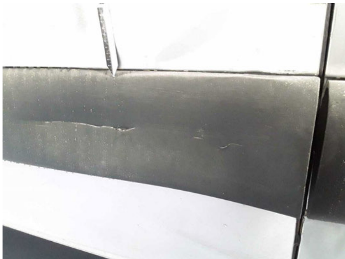
Beschädigung 16: Seitenwand links: Schutzleiste - beschädigt - erneuern
