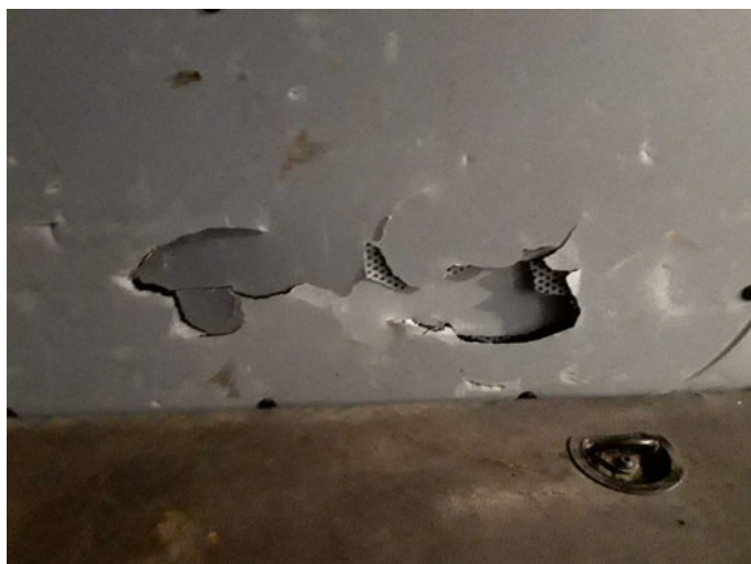
Beschädigung 12: Schiebetür rechts: Verkleidung Sperrholz unten - beschädigt - erneuern
