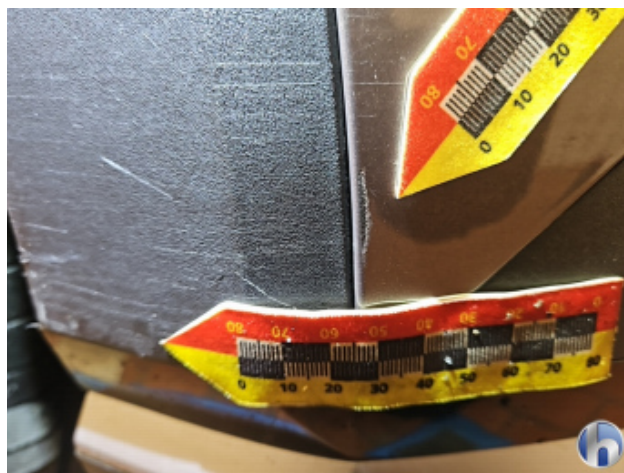
6. Radlaufverbreiterung re.vo. Abschürfung - Erneuern
