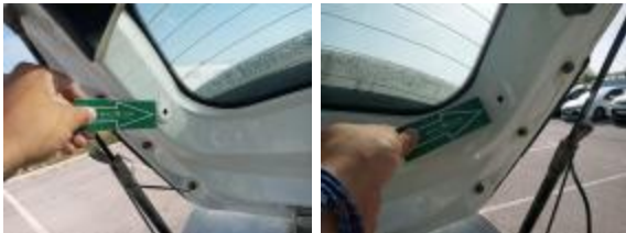
Interior Dañado Control
