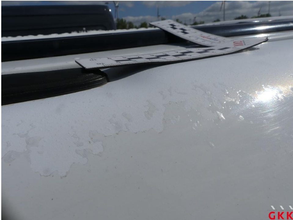
Bild 25. Seitenwand rechts, Lackierung abgeplatzt, lackieren
