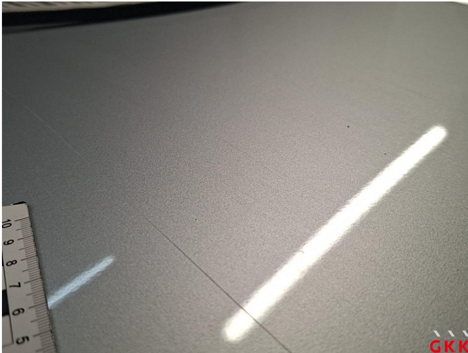
Bild 41 Dach, beschädigt, instand setzen - lackieren
