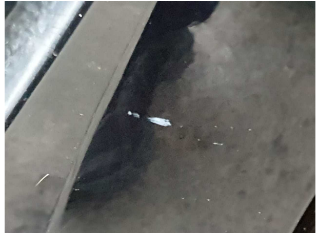
Beschädigung #15: Seitenwand links: Einstieg - Delle / Lackschaden - instandsetzen und lackieren
