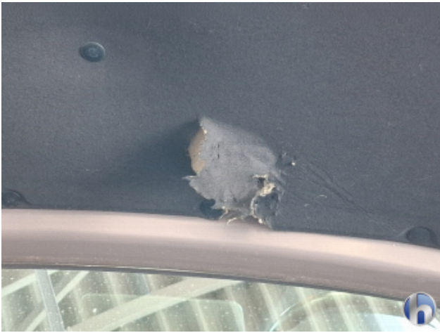
5. Motordämmmaterial Beschädigt - Erneuern
