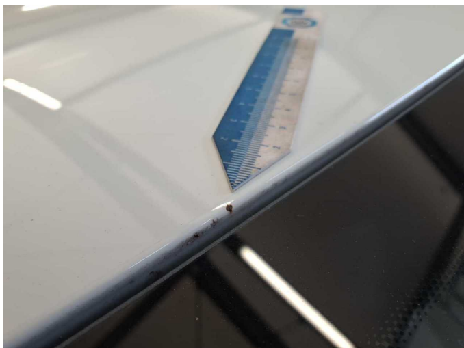
Damage 9: Roof: Roof (Steinschlag mit Korrosion) - Corrosion - Repair and paint
