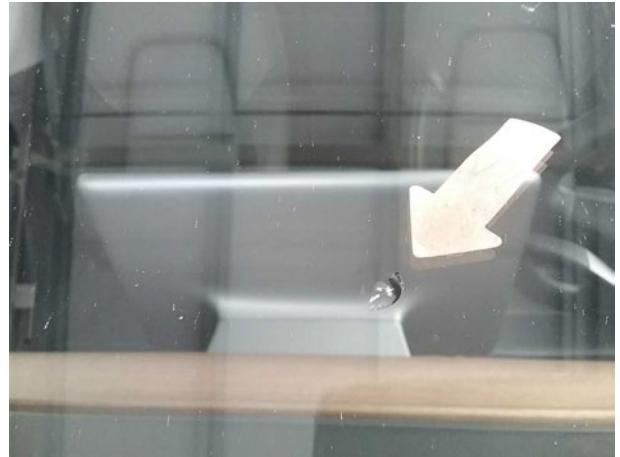
Beschädigung #3: Verglasung: Frontscheibe (mit Rissbildung) - Steinschlag - erneuern
