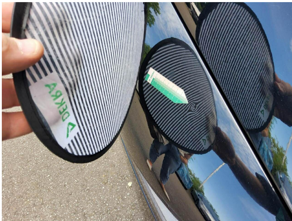
Bild 9 : Seitenteil hinten links, eingedellt, drücken
