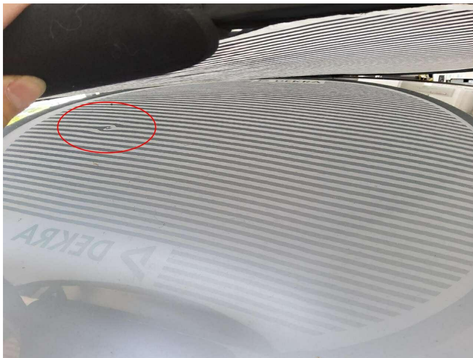
Bild 37 : Dach, mehrfach eingedellt, drücken
