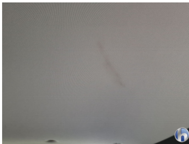
3. Dachhimmel Verschmutzt - Reinigen
