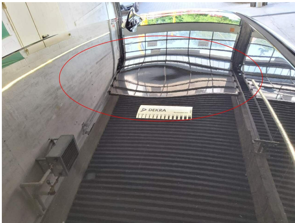
Bild 21 : Dach, mehrfach großflächig eingedellt
