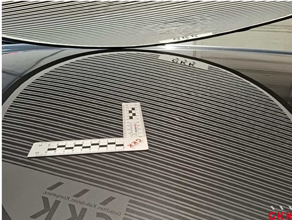
Bild 17 Dach, beschädigt, instand setzen - lackieren
