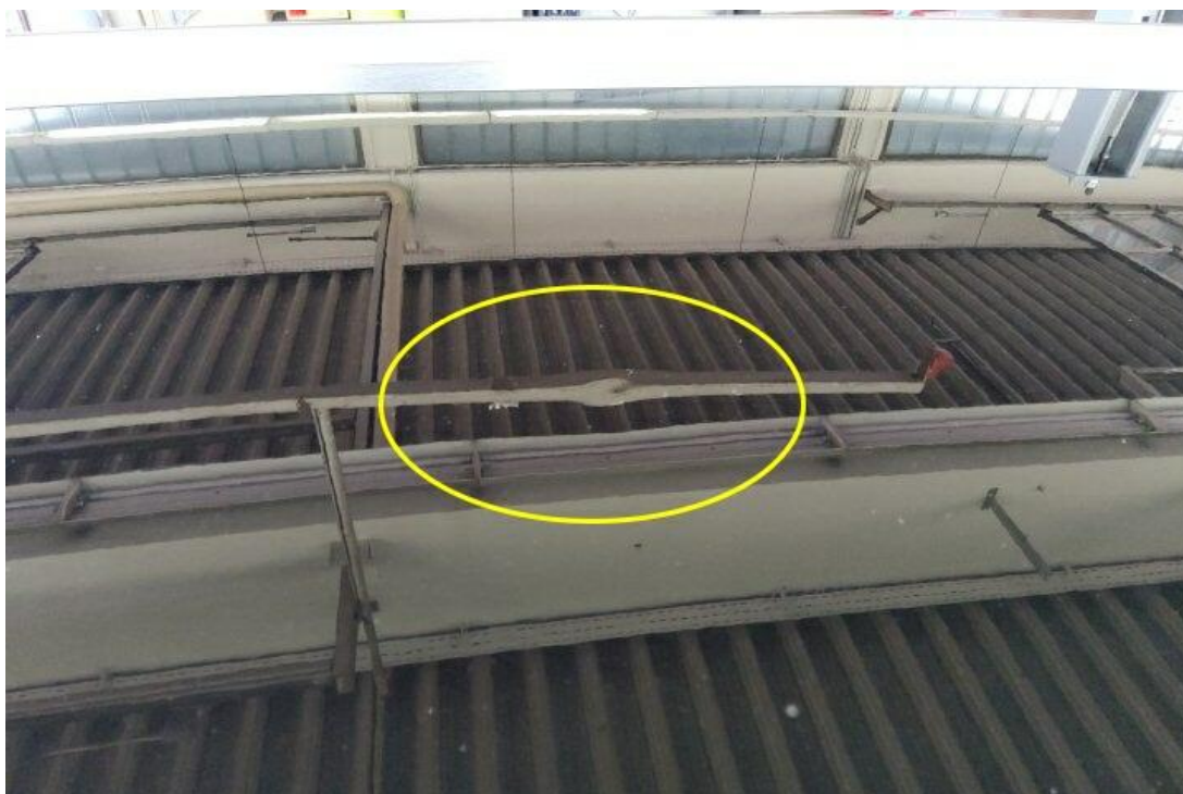
Bild 16 : Dach, eingedellt, drücken
