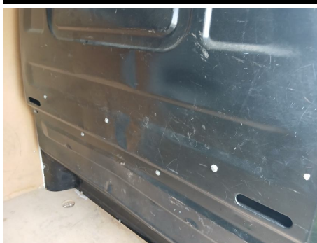
Caja de carga completa / - / Abolladura
