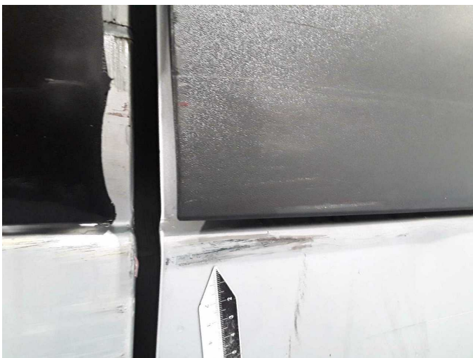
Beschädigung 23: Schiebetür rechts: Schutzleiste - beschädigt - erneuern
