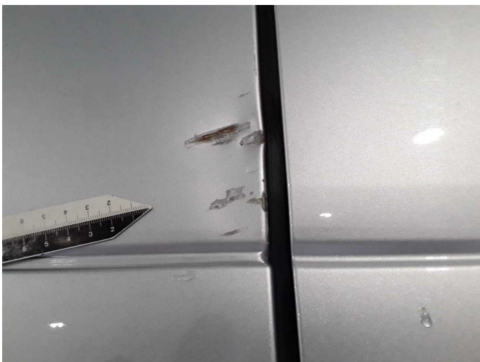
Beschädigung 30: Seitenwand rechts: Seitenwand - beschädigt - erneuern
