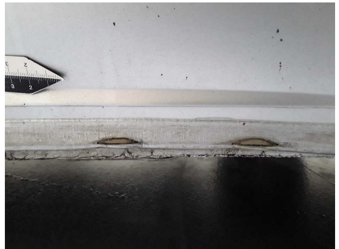
Beschädigung 8: Schweller links: Schweller - beschädigt - erneuern
