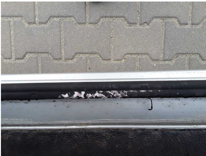
Beschädigung 4: Schiebetür rechts: Türdichtung - beschädigt - erneuern
