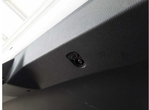
Beschädigung #5: Heckklappe/-tür: Griff innen - gebrochen / gerissen - erneuern
