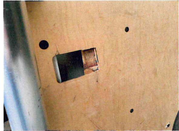
Beschädigung 13: Seitenwand links: Innenverkleidung - gebrochen / gerissen - erneuern
