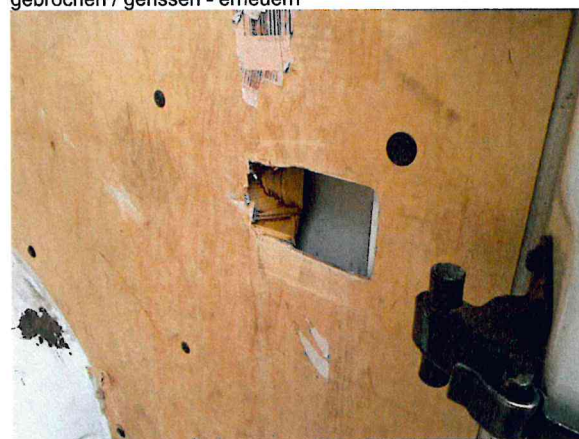
Beschädigung 12: Seitenwand rechts: Innenverkleidung - gebrochen / gerissen - erneuern
