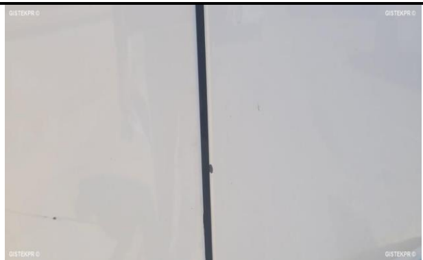
Foto daños internos 13
