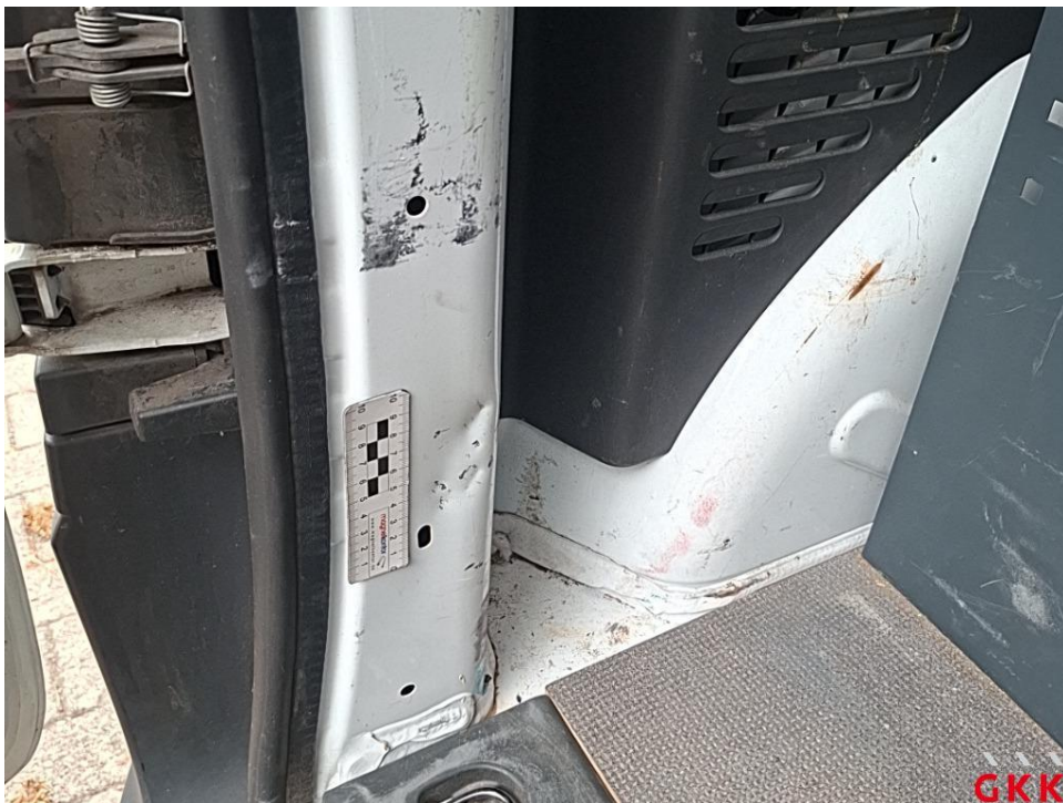
Bild 16. D- Säule links, beschädigt, instand setzen - lackieren
