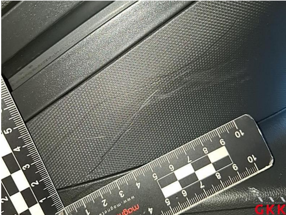
Bild 37. D- Säule links, Innenverkleidung, beschädigt, ersetzen
