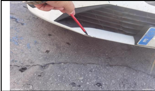
Foto daños externos 1
